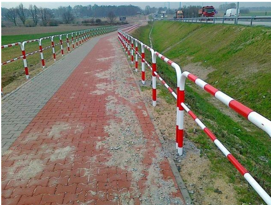
Ilustracja 7. Przykład nieprawidłowego zastosowania nawierzchni i bariery na trasie pieszo-rowerowej
